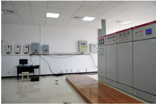
光伏电站运维与智能微电网控制实训室
